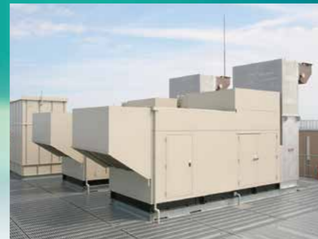
自家発電設備
